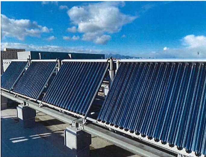
図1 屋上に設置されたソーラー集熱パネル
