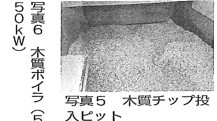
写真5 木質チップ投入ピット
